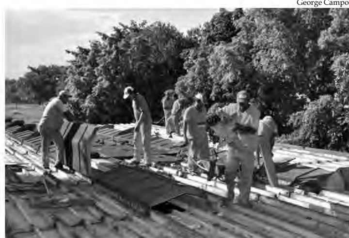
A Escola Municipal Casa da Criança Presidente Getúlio Vargas, no Bairro da Luz, entrou em reforma emergencial para melhor atender aos alunos
