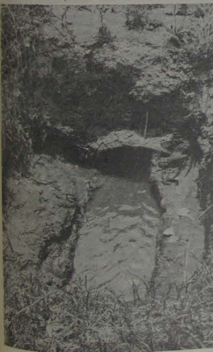
Estado permanente, há muitos anos, da rede de manilhas que escoam as águas de esgotos sanitários e das chuvas, do bairro Califórnia e área do Colégio Monteiro Lobato, na Travençolo Francisco Soares. A estereográfica sobre a manilha, demonstra a pouca vazão disponível.
