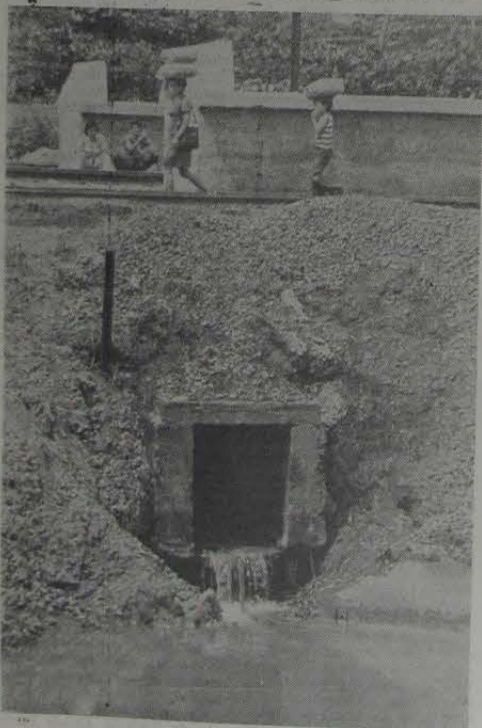
Bueiro no leito da Central do Brasil, em Morro Agudo, com pequena dimensão e de piso alto, que dificulta o escoamento rápido das águas, provocando atuais inundações pelo lado oposto da linha.
