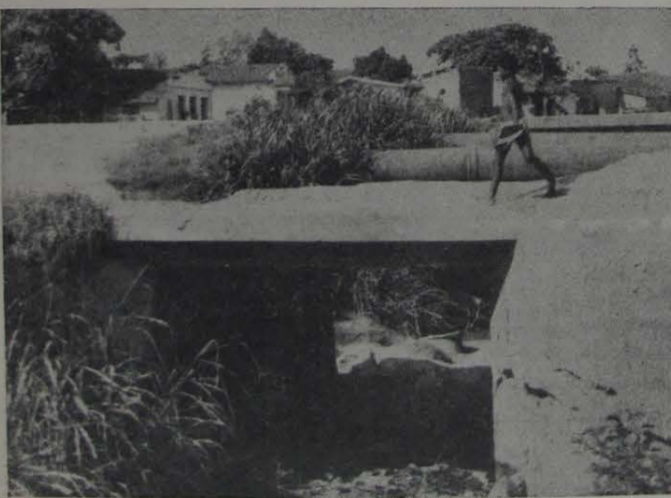
PONTE — A foto mostra o estado em que se encontra o único meio de ligação entre os bairros Azeite Branca e Heliópolis, pela Av. Augusto Vasco Aranha. Ao passar um ônibus da Viação Caravelle a ponte cedeu, obrigando os demais coletivos que fazem as linhas Miguel Couto-São João de Meriti, São João-Nova Aurora e Bellardi Roxo-Vila de Cava, a moldar a em seus itinerários, deixando os que residem nas proximidades da ponte sujeitos a percorrerem alguns quilômetros a pé. O Vereador Waldir Fortunato já comunicou o fato ao Prefeito Joaquim de Freitas.
