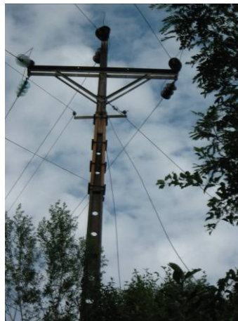
Figura 20: Linha de transmissão
