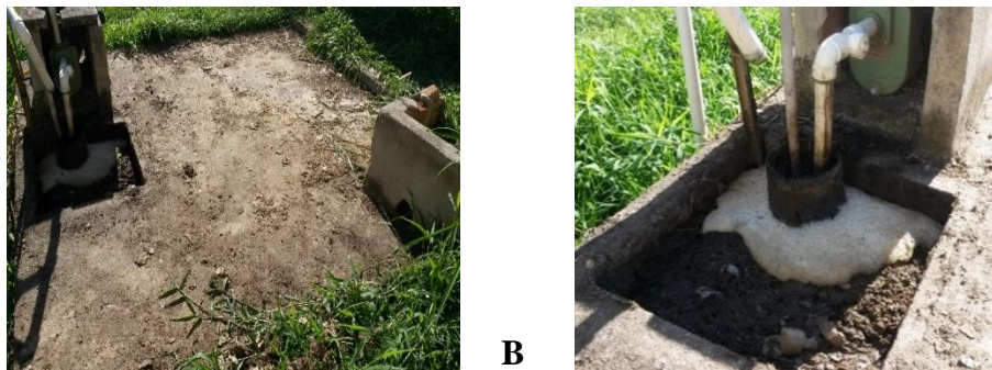
Figura 2 - (A) Esterqueira (P1) para acúmulo da ARB produzida no SIPA; e (B) bombeamento instalado em P1 com proteção da tubulação de sucção.
