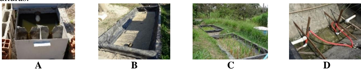
Figura 5 - (A) caixa divisora de vazão; (B) leito impermeabilizado e com material suporte/filtrante; (C) SAC's com taboa e capim vetiver; (D) mangueiras para o controle do nível internos dos SAC's.
