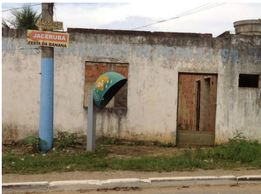
Figura 18: Prédio da associação em ruínas, em 2014 622
