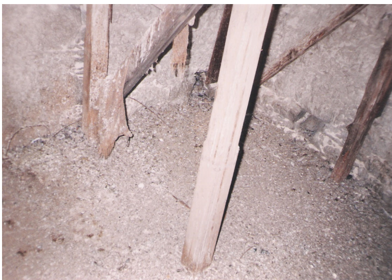
Figura 2: Detalhe da torre da igreja com fezes de pombos. Local selecionado para colocação de armadilha.
