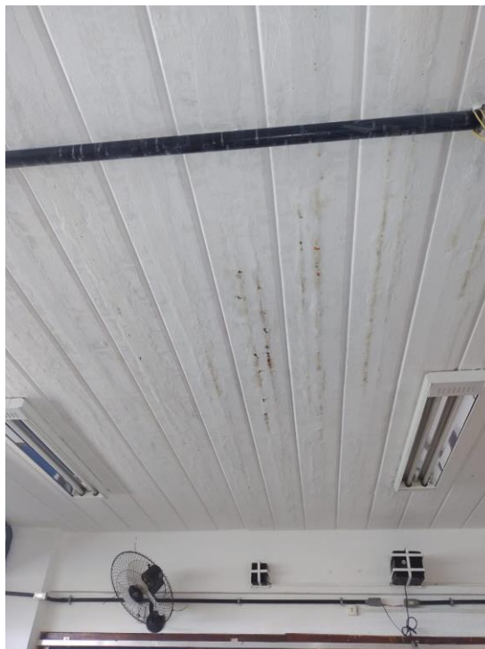
Teto de uma sala de aula com marcas de infiltração/vazamento de água da chuva acumulada no telhado, janeiro de 2020.
