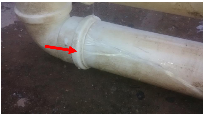
FIGURA 22: Indicação de vazamentos nas conexões
