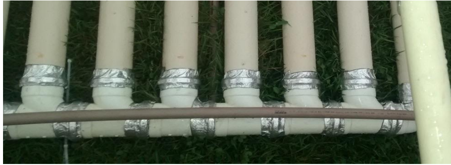
FIGURA 23: Juntas de conexões com vedação e manta asfáltica
