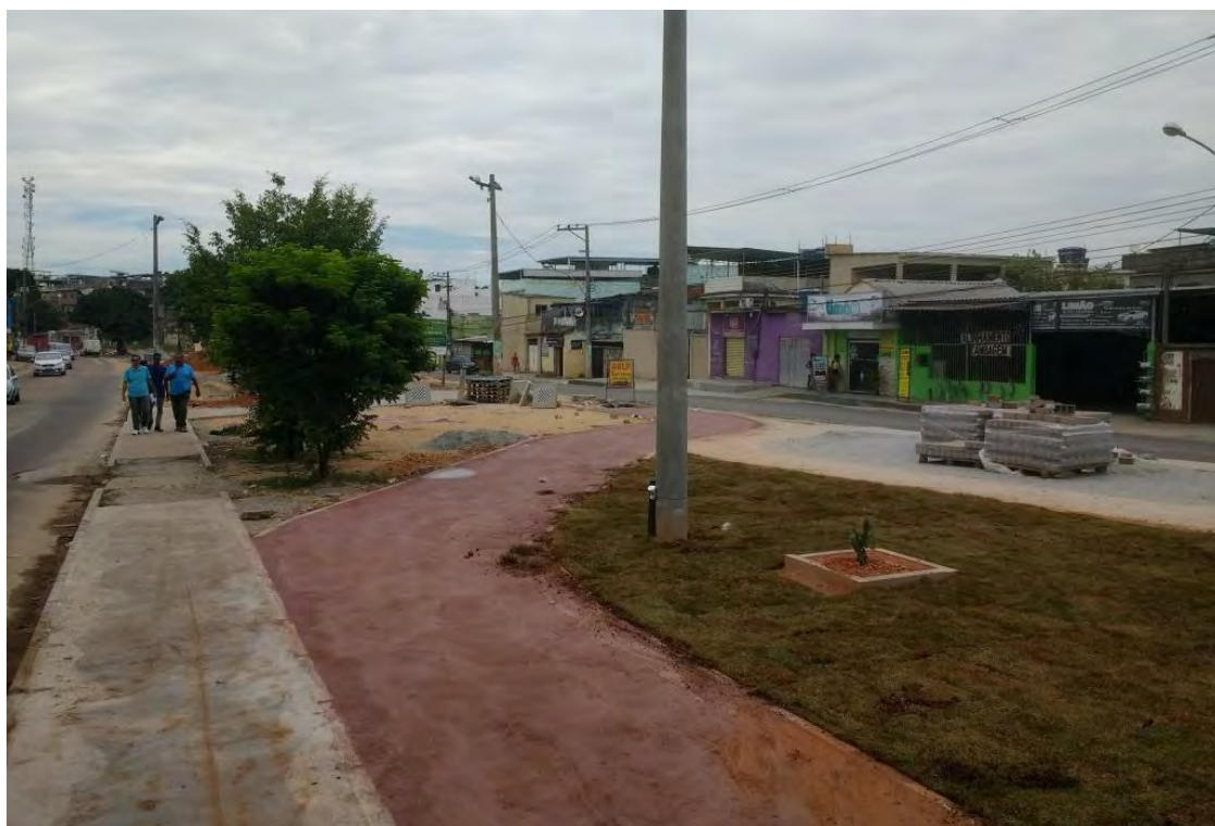
Figura 36: Trecho da ciclovia bairro São Mateus em execução, com as melhorias urbanísticas e paisagísticas promovidas pelo projeto. (Fonte: Marcelo Mourão/Ano:2018)
