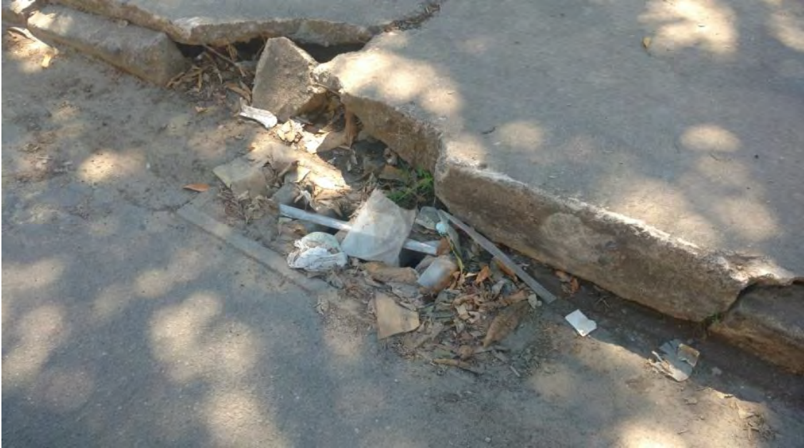
Figura 40: Drenagem prejudicada bairro Vilar dos Teles (Fonte: Autor: 2017)
