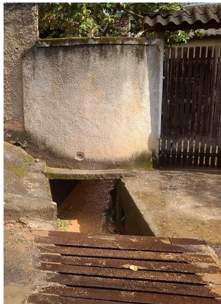
Figura 86: Foto do cruzamento da Rua 42 com o canal que escoar o bairro Boa Esperança com estreitamento da seção. Fonte: acervo do autor.
