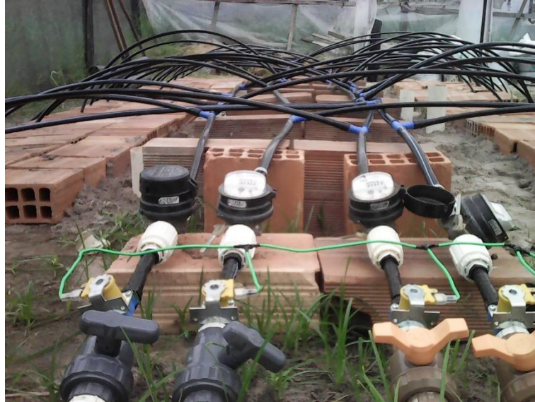
Figura 21: Cabeçal de controle e montagem do sistema de irrigação.
