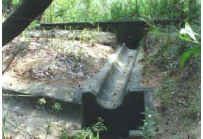
Fotografia 9 – Caixa de passagem
