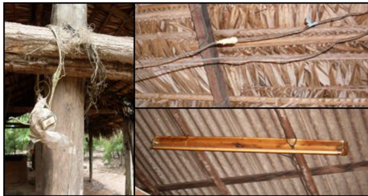
Figura 11. Luminária sem proteção e instalações elétricas inadequadas.
