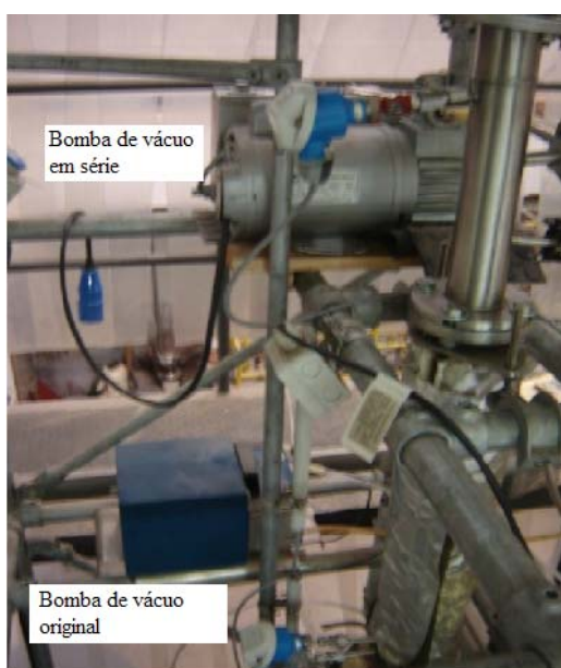
Figura 10. Bombas de vácuo original e a nova bomba em paralelo não controlável
