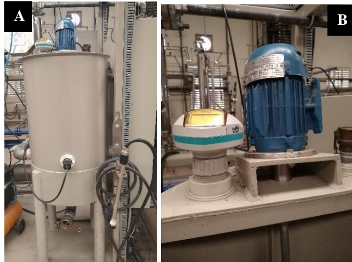
Figura 42. (A) Tanque de preparo de fluido e (B) sensor de nível e agitador.
