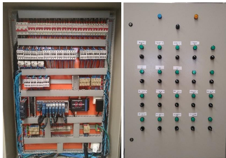
Figura 52. Quadro de comando.
