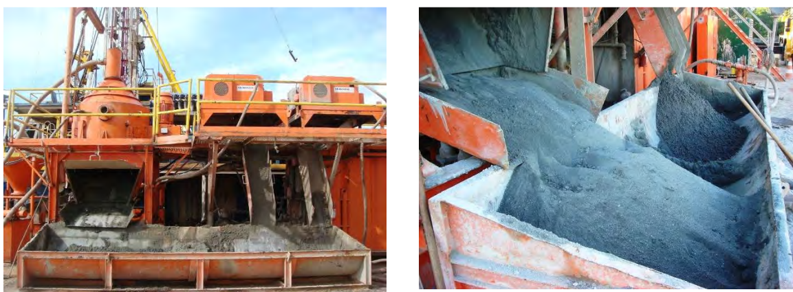
Figura 2. Sistema de recuperação do fluido de perfuração, utilizado pela Sonda BCH 05, no poço 7-MGP 98-D BA, no campo de Miranga, na Bacia do Recôncavo, Bahia. À direita, detalhe do cascalho de perfuração oriundo do Secador “Vert G” e das Centrífugas I e II. Fotos: Freitas, 2010.
