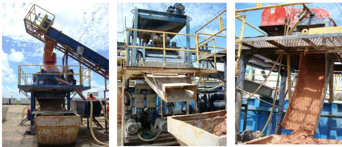
Figura 3. Sistema de recuperação do fluido de perfuração, utilizado pela sonda SC-82, no poço 7-SMC 50-D AL, em São Miguel dos Campos, Alagoas. À esquerda, o Secador Vertical Vortex, no centro, o Mud Cleaner e à direita a Centrífuga de dupla função. Fotos: Freitas, 2010.
