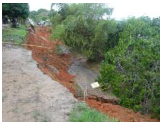
Figura 22. Estrada de acesso a Umariáçu destruída.
