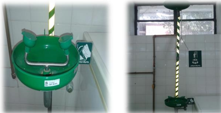
Figura 6 e 7: Lava olhos e chuveiro de emergência.
